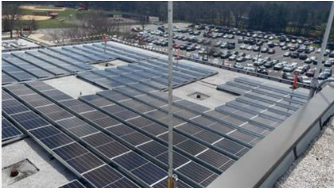
Solar Panels on Roof of Voorhees HS
